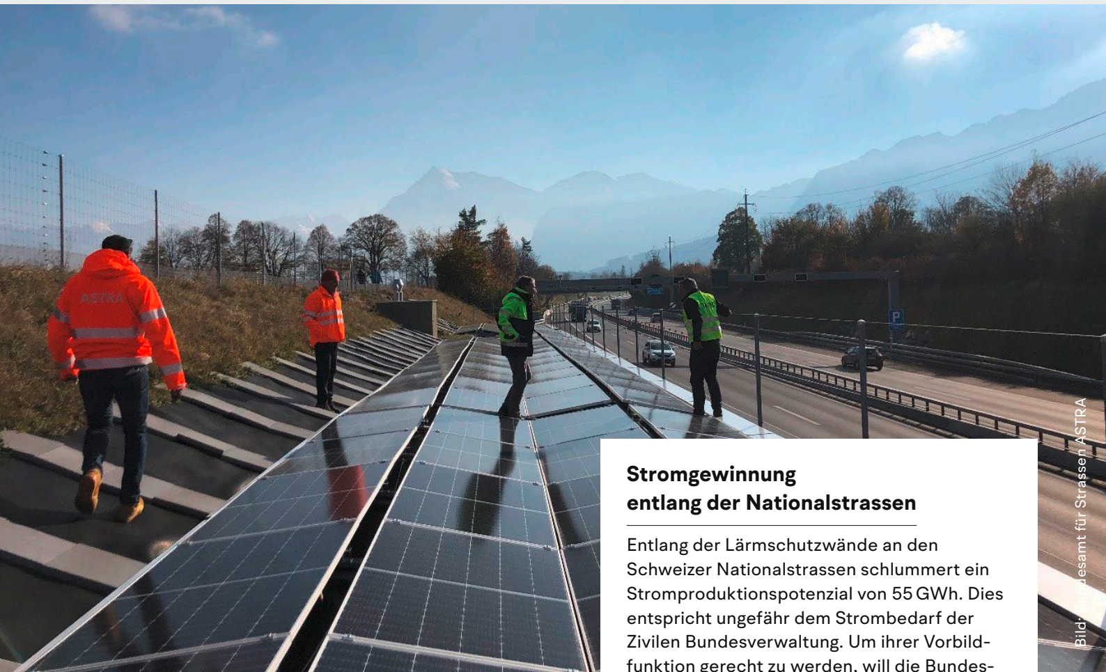
Mitarbeitende des ASTRA inspizieren eine PV-Anlage an der A6 im Kanton Bern.
